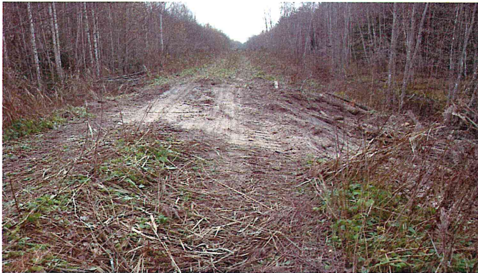
Bebru postījumi dambim D-1 remonts pik. 53/00
